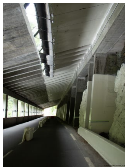
Réflecteurs fixés sur la voûte
