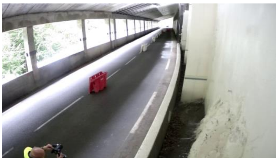
Partie équipée de réflecteurs avec piédroit peint
